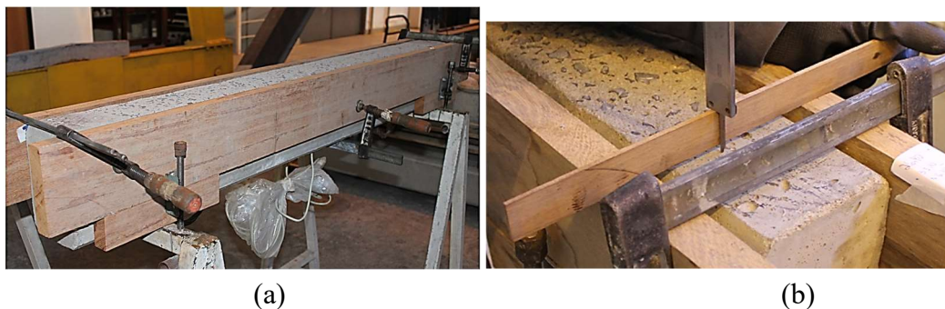
Figura 36. Viga posicionada para execução do reforço sobre cavaletes (a) e ajuste da altura das guias de madeira (b).
