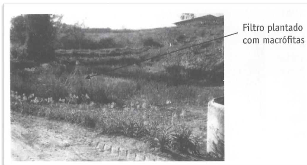
Figura 6 – Filtro plantado com macrófitas instalado em Agrônômica/SC: Unidade de Tratamento A.
