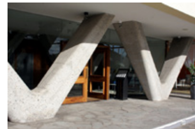
Figura 2.53. Detalhe dos pilotis em forma de V no acesso térreo do edifício.
