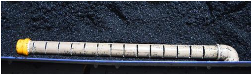
Figura 27: Descarregador de fundo com a extremidade obstruída por um CAP.
