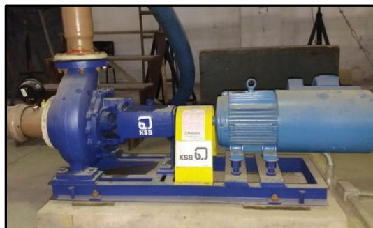
Figura 25 - Conjunto motor-bomba de bombeamento de água do modelo físico Complementar.
