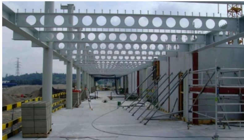
Figura 1.12 – Centro de aço da ArcelorMittal
