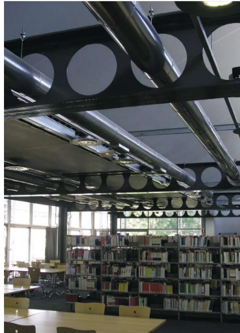
Figura 1.7 – Passagem de dutos
