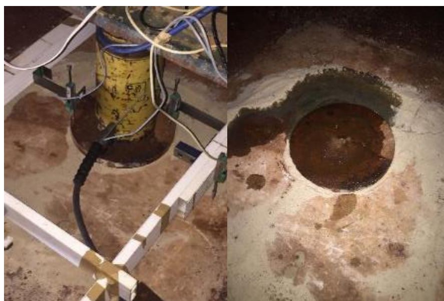
Figura 4.7: CL90E30 depois da ruptura.
