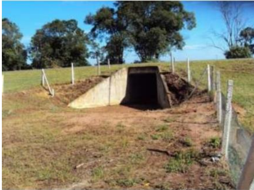
Figura 3 - Passagem de fauna do tipo caixa
