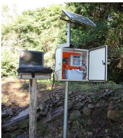
Figura 3.10: Sistema de data logger e painel solar do linígrafo de pressão.
