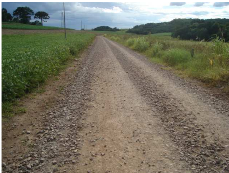
Figura 22: Ilustração do defeito segregação de agregados
