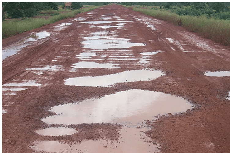
Figura 23: Ilustração do defeito buracos e panelas
