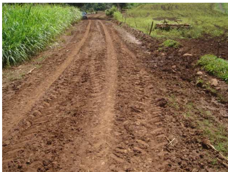
Figura 24: Ilustração do defeito drenagem lateral
