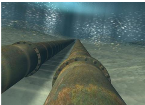
Figura 2.11 Dutos metálicos em ambiente agressivo.
