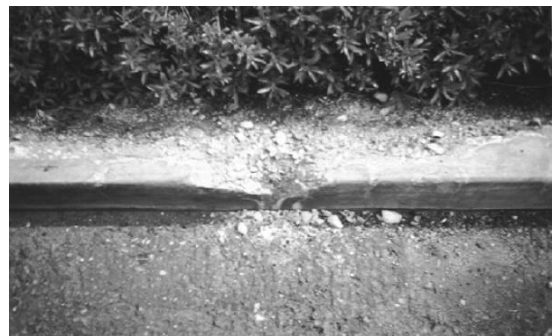
Figura 7: Meio-fio deteriorado devido ataque por sulfato
