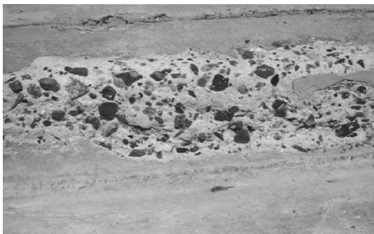
Figura 6: Deterioração visível de placas de concreto expostas aos sulfatos \text{Na}^+ e \text{Mg}^+ presentes nas águas subterrâneas
