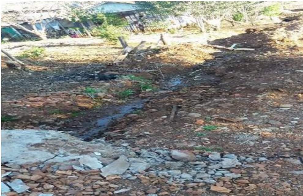
Figura 5: Lançamento de esgoto em valas na zona urbana.
