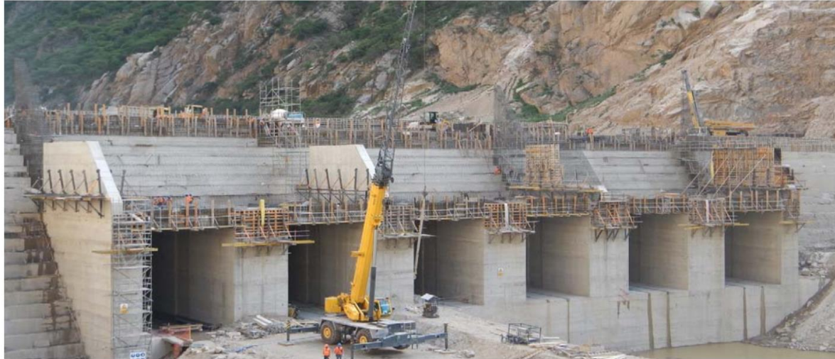
Figura 14: Construção dos descarregadores de fundo do Cerro del Águila (SAYAH et al., 2016).
