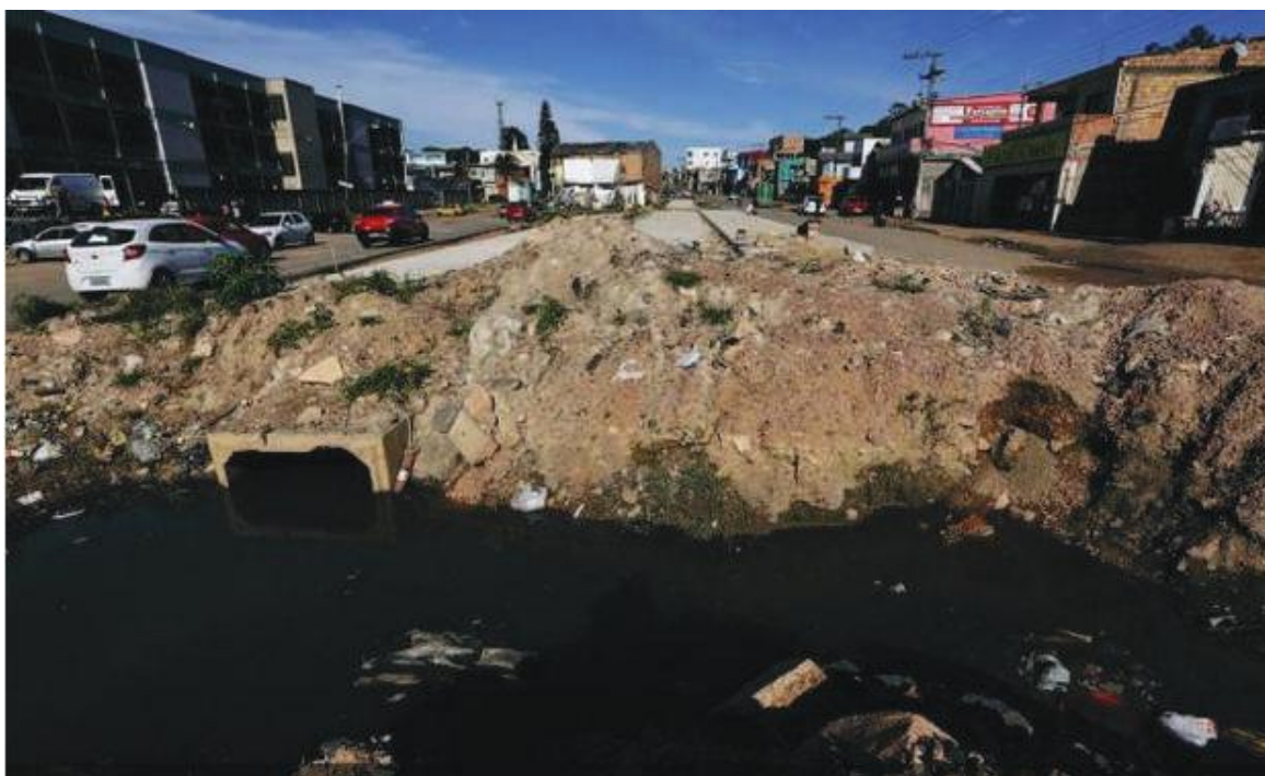
Esgoto a céu aberto nas obras da Av. Tronco, o buraco já esta aberto há quase 6 meses. 22/10/2016. Fonte: Guilherme Santos/Sul21.
