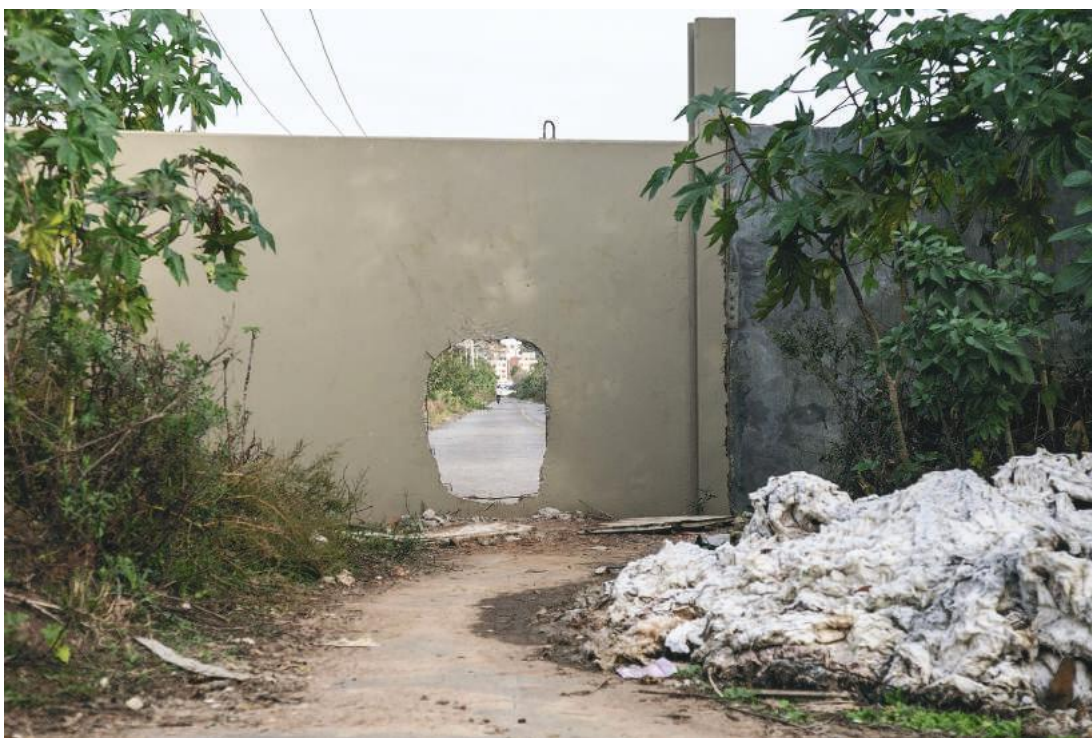
A partir das primeiras remoções, a Infraero construiu um muro na área, bloqueando a passagem da Vila Dique para a Avenida Sertório. O buraco foi aberto pelos moradores. 16/08/2016. Fonte: Guilherme Santos/Sul21.
