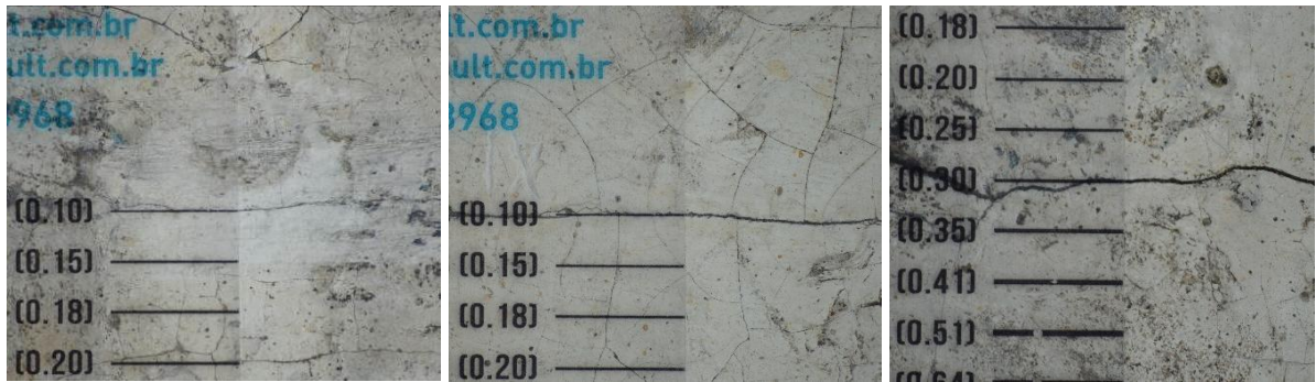
Figura 5.49: Exemplo de fissuras no recapeamento de 50 mm. Fonte: fotos do autor.
