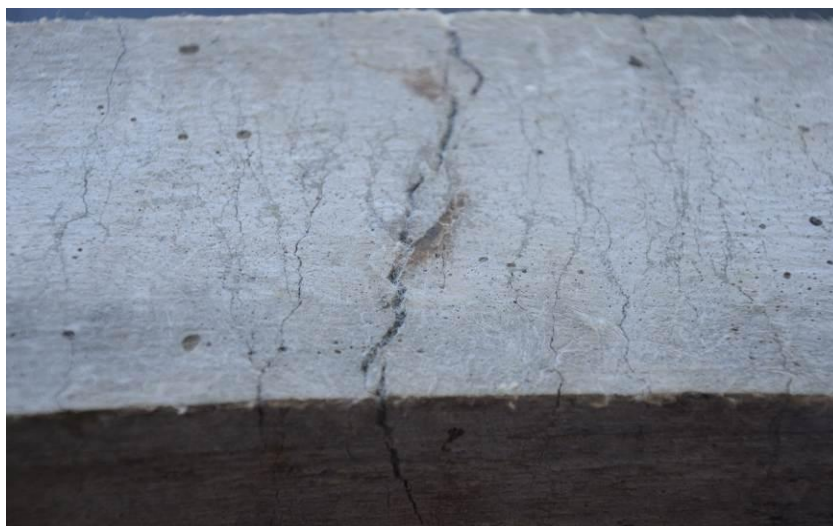
Figura 5.16: Face inferior da viga ECC Ref 302 após terminado o ensaio de fadiga. Fonte: foto do autor.
