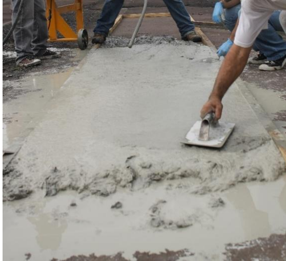
Figura 5.41: Exsudação observada na construção do recapeamento de 50 mm. Fonte: foto do autor.
