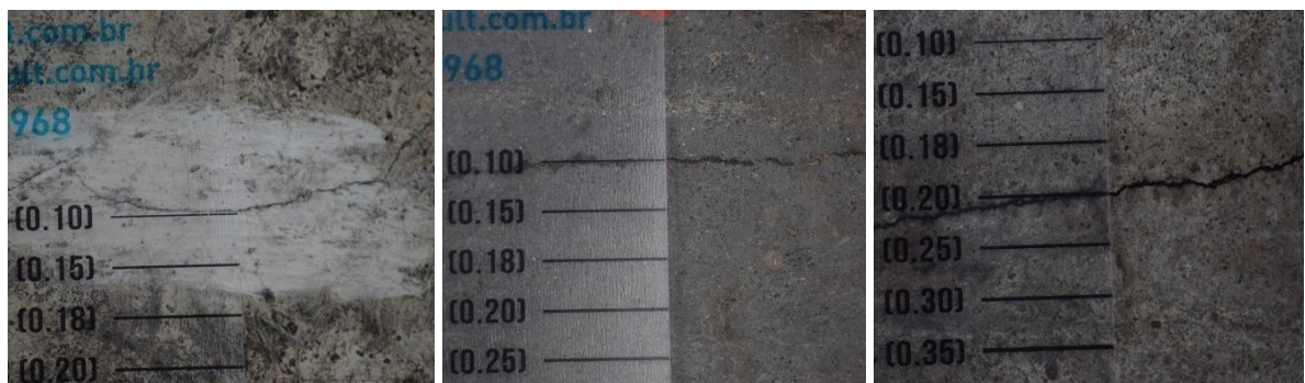
Figura 5.50: Exemplo de fissuras no recapeamento de 30 mm. Fonte: fotos do autor.
