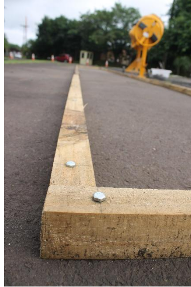
Figura 3.44: Detalhe da fixação da madeira no pavimento existente. Fonte: foto do autor.
