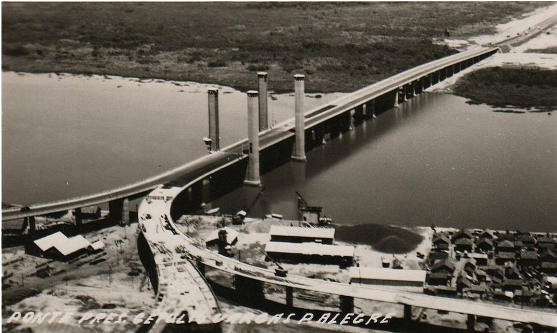
Figura 8. A travessia Régis Bittencourt, em processo final de construção, no final dos anos 50.
