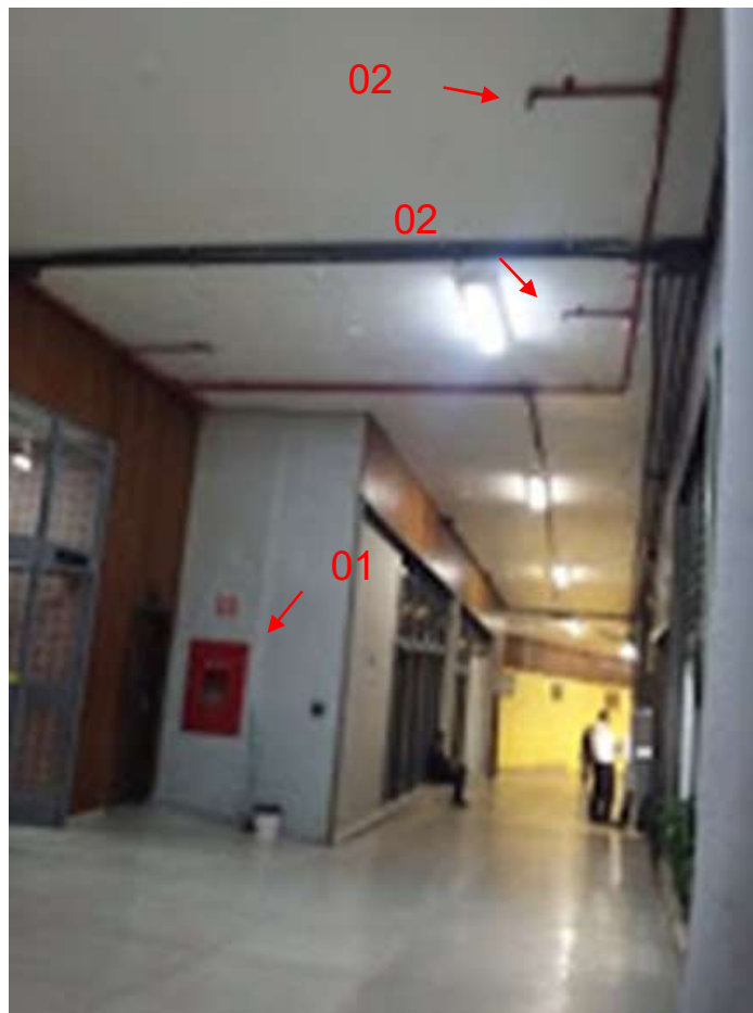
Figura 27 - Imagem mostrando o sistema de hidrante (01) e chuveiro Automático ( sprinklers ) (02)
