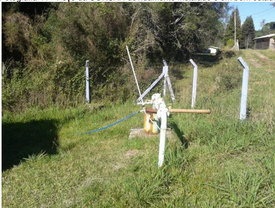
Fotografia 11 - Poço da CORSAN devidamente instalado e em bom estado.
