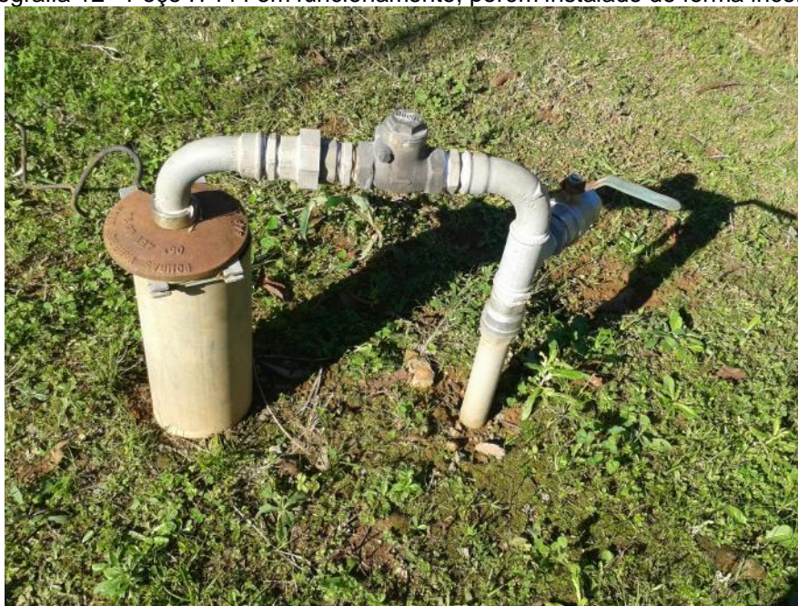
Fotografia 12 - Poço IT444 em funcionamento, porém instalado de forma incorreta.
