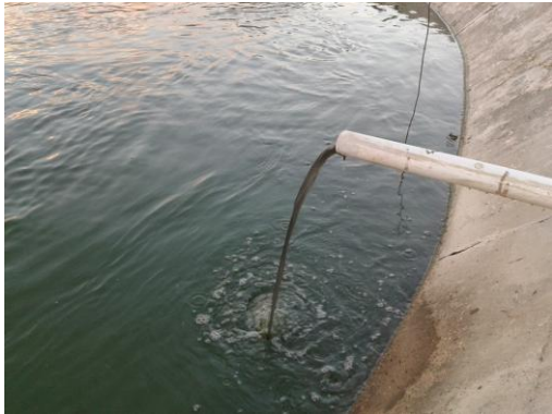
Perda de lodo no efluente do UASB
