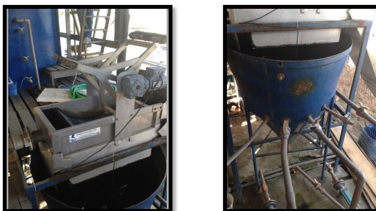
Figura 5.1 Gradeamento final e tanque pulmão de alimentação dos reatores
