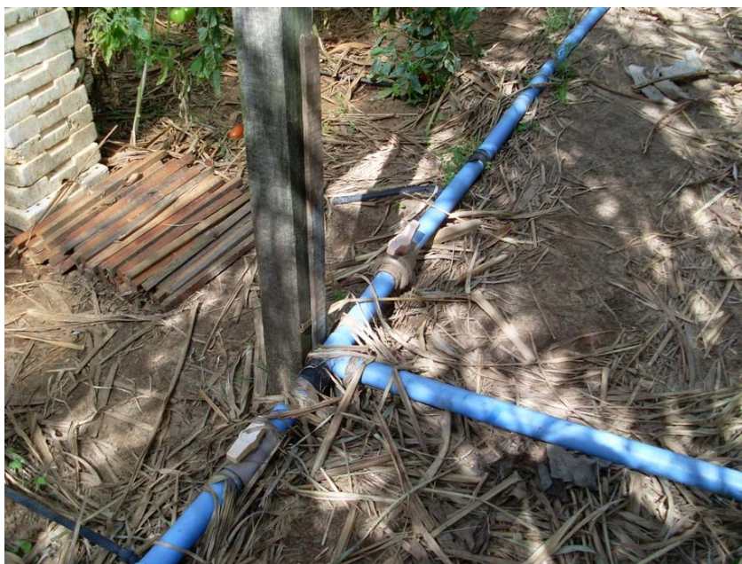
Fotografia 7 - Rede de Distribuição de Água em Estufa Arquivo do autor, 2008.
