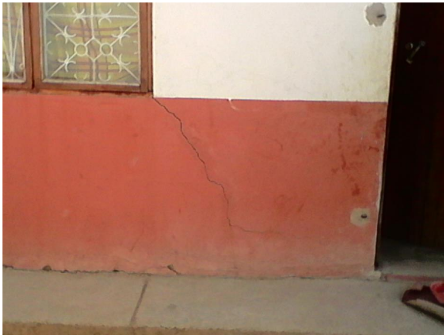
Figura 57: marcas visíveis da degradação e rachas em um dos compartimentos da casa reassentamento da empresa Vale no bairro 25 de setembro.
