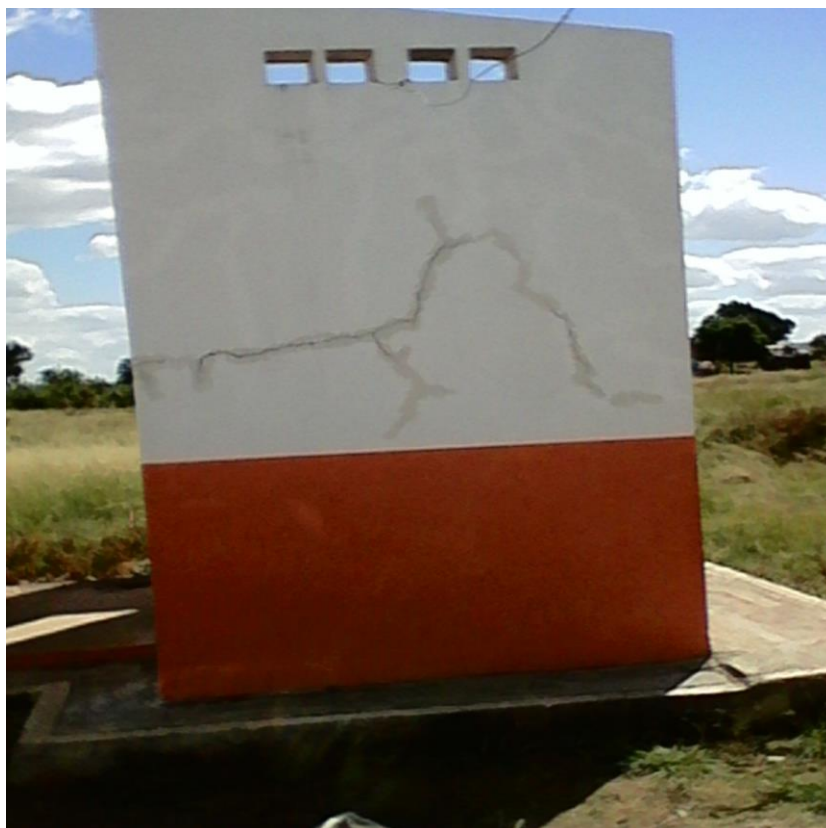
Figura 58: Racha em uma das paredes do banheiro da casa no Reassentamento de Cateme, Moatize.
