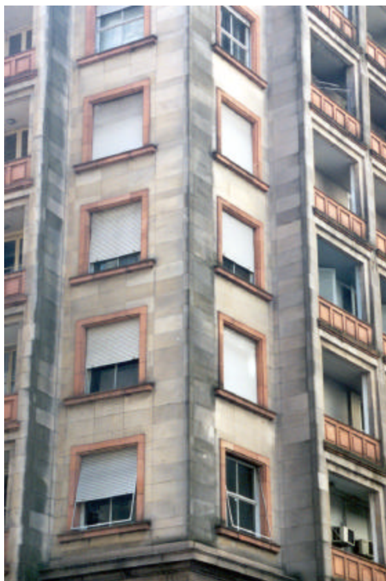
Figura 4.40 Maior marcação das juntas do revestimento – ed. Sulacap
