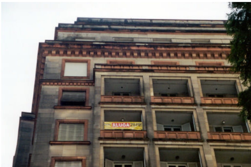
Figura 4.35 Parte da fachada Sul do ed. Sulacap (mais acentuado manchamento)
