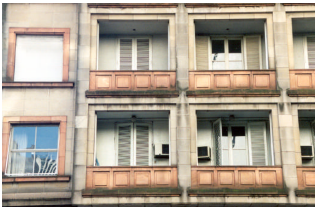
Figura 4.36 Detalhe da fachada Sul do ed. Sulacap (presença de microorganismos)
