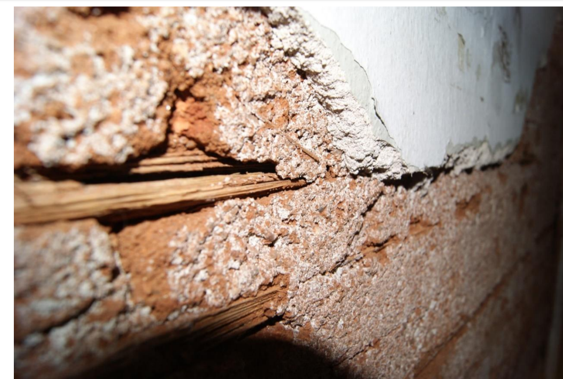
Figura 1 – Descolamento de revestimento interno de edificação histórica
