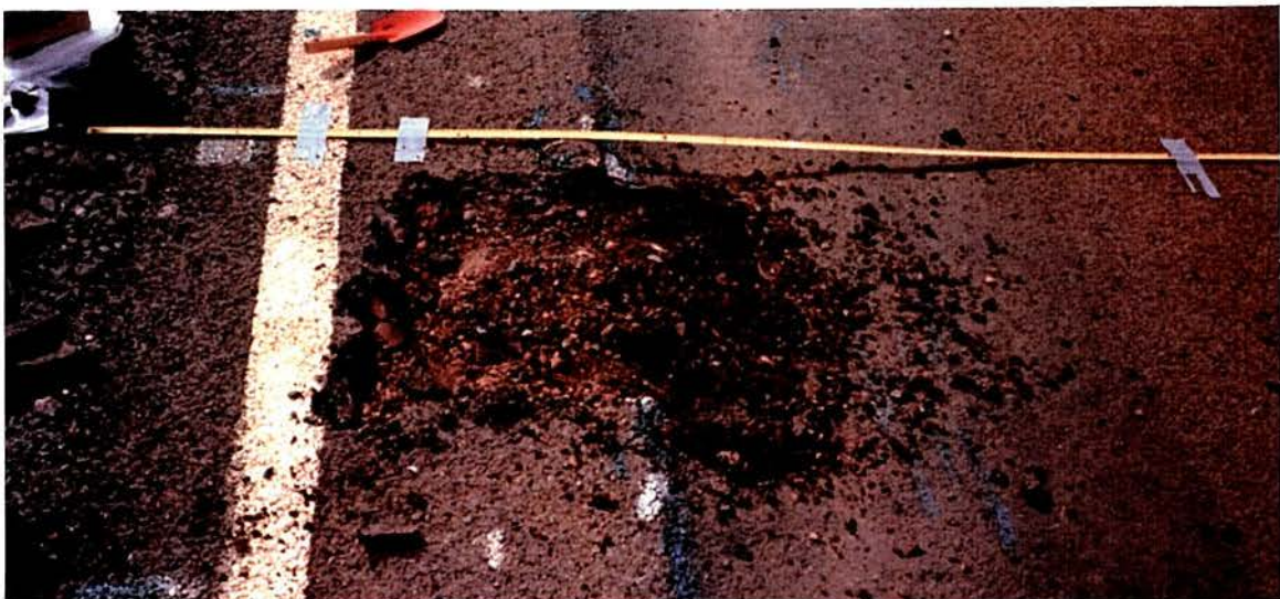
FIGURA 7.16 - Concentração de umidade entre as seções S5 e S6 do setor 0110
