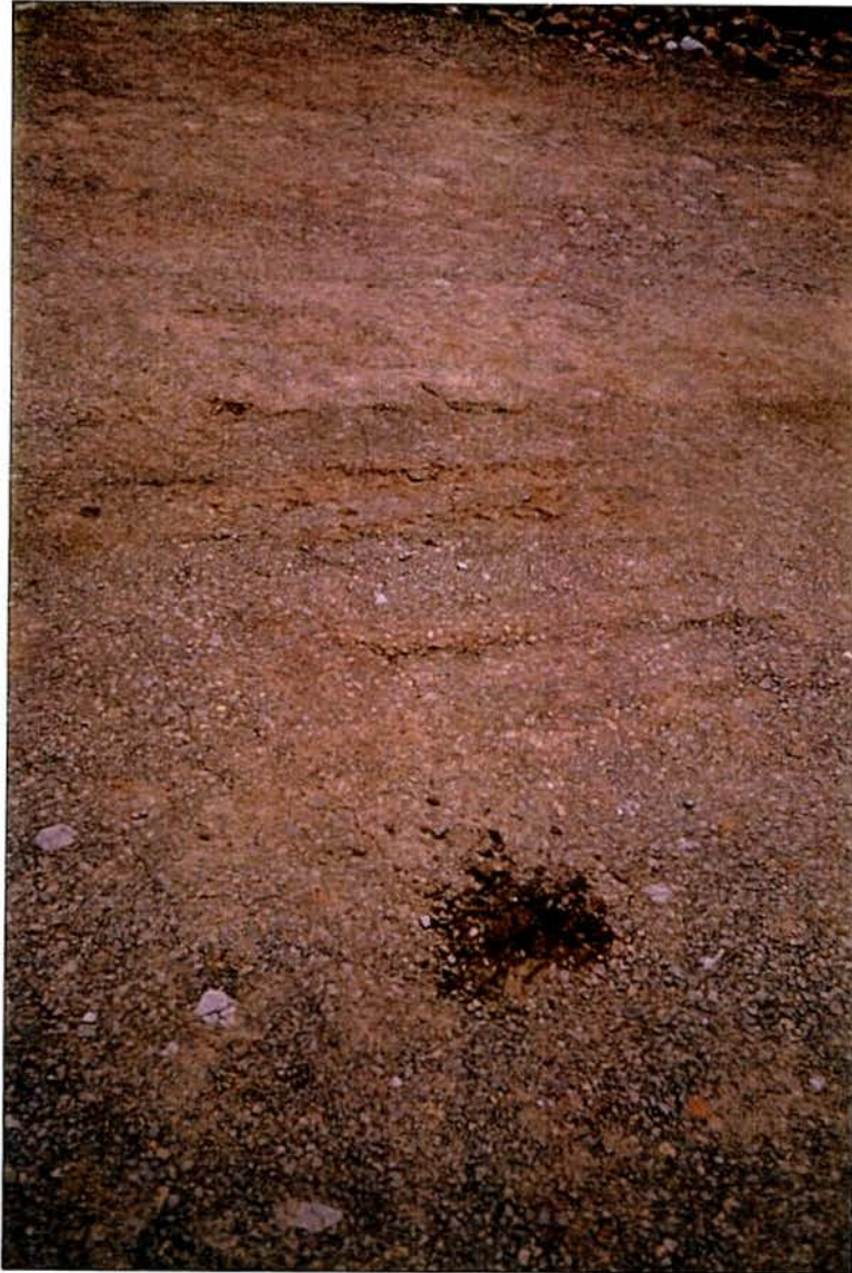
FIGURA 5.11 - Plastificações na camada de macadame a seco da Pista 08 devido à saturação
