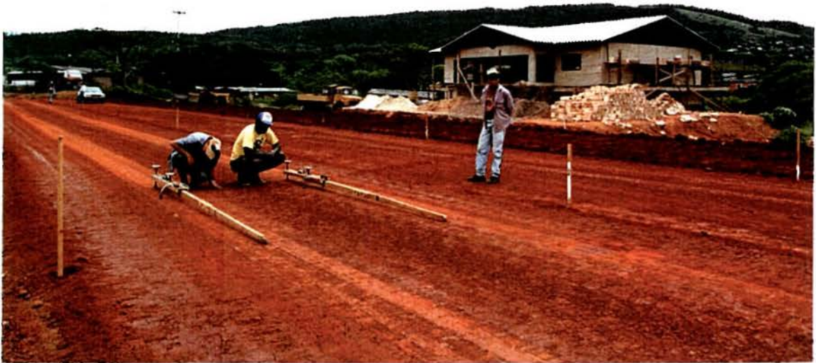
FIGURA 7.10 - Trincas de retração no topo do subleito (lado esquerdo da foto)
