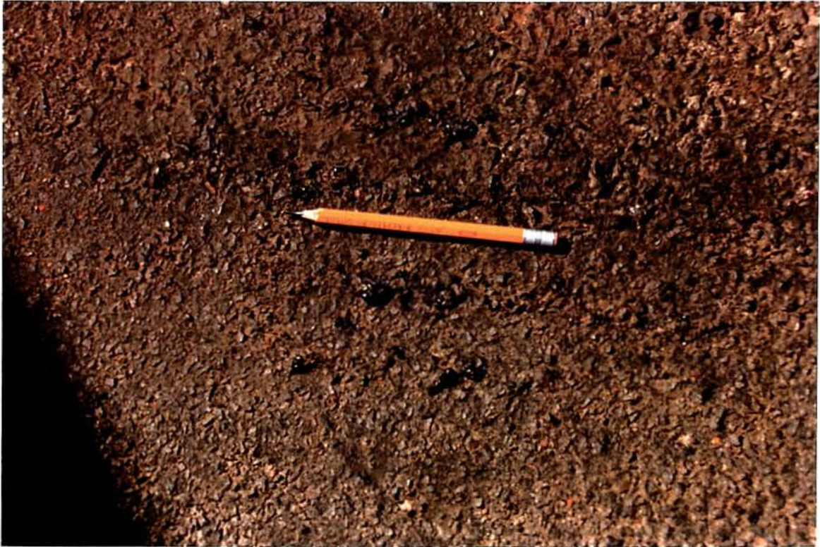
FIGURA 7.18 - Exsudação com nível de severidade médio no setor 0110
