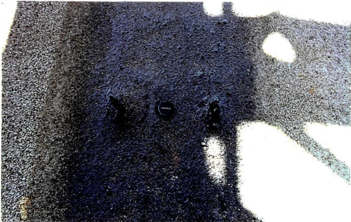
FIGURA 7.19 - Arrancamento do revestimento decorrente de exsudação entre as seções S4 e S5 do setor 0408
