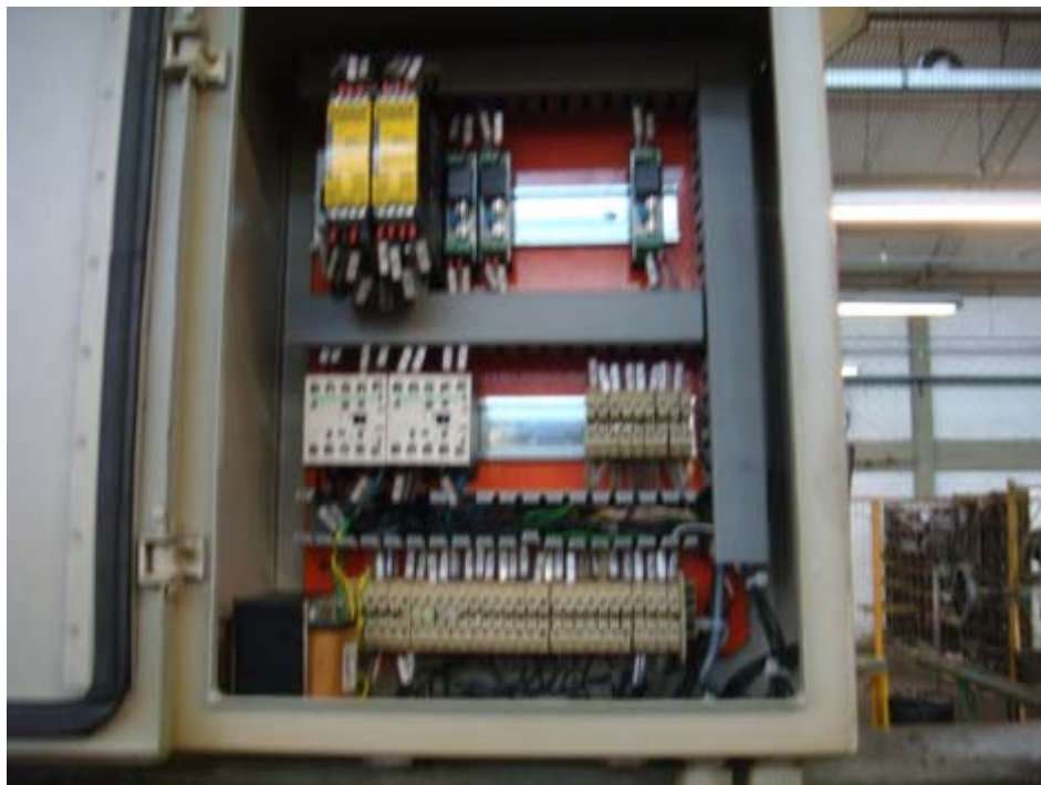
Figura 12 – Configuração do quadro de comando. Fonte: Foto do autor, 2014.
