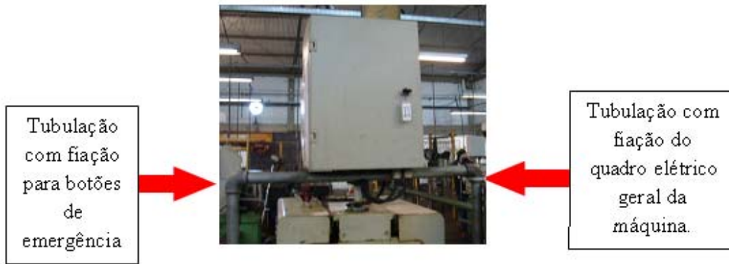
Figura 11 – Quadro do sistema elétrico de segurança. Fonte: Foto do autor, 2014.
