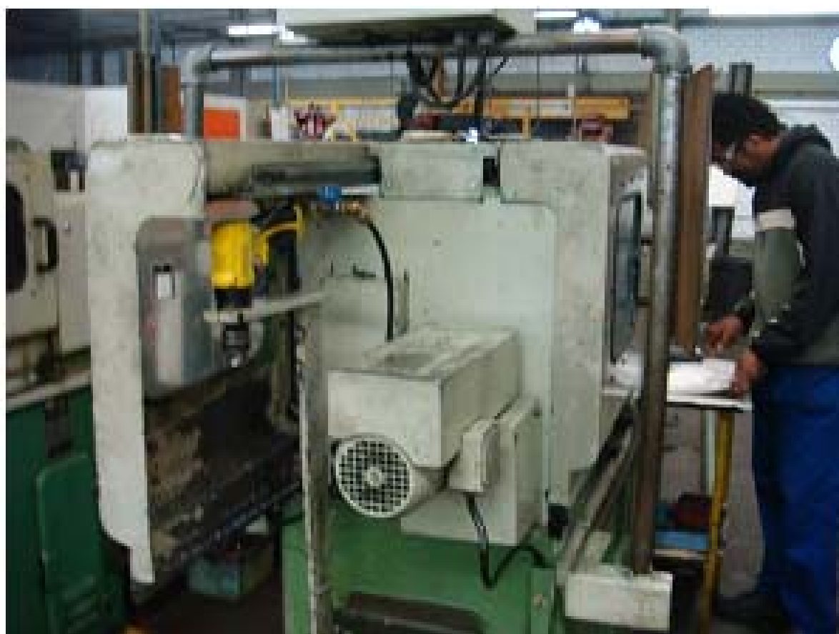
Figura 18 – Proteção mecânica fixa item 4. Fonte: Foto do autor, 2014.
