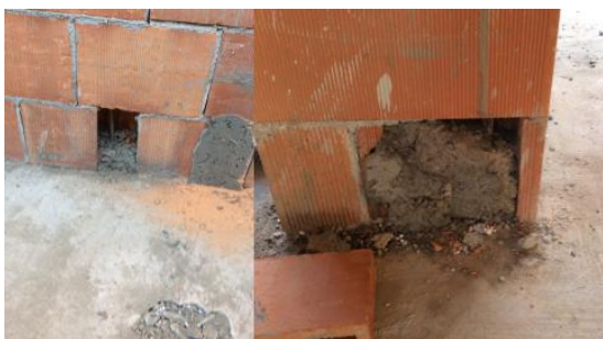
Figura 59: Reprovações de qualidade pertencentes ao pacote genérico de colocação de graute em alvenaria estrutural
