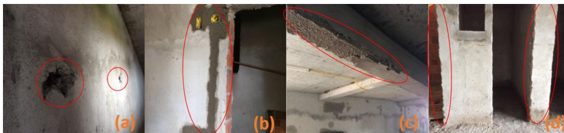
Figura 98: Reprovações de qualidade pertencentes ao pacote genérico de execução de rebocos
