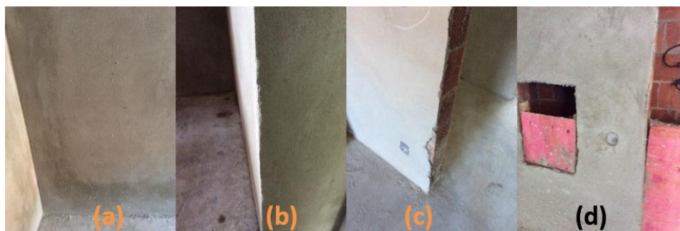
Figura 55: Reprovações de qualidade pertencentes ao pacote genérico de execução de reboco
