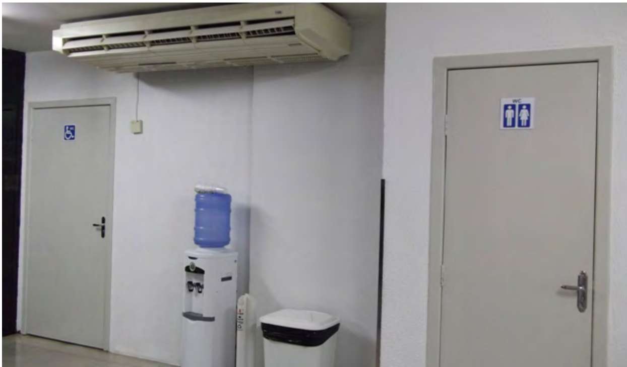
Figura 8 - Após as intervenções: novos banheiros acessíveis, climatização e água para os usuários
