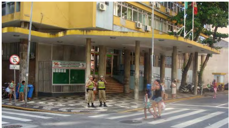
Figura 3-16 Marquise orgânica do Edifício das Diretorias, vista da esquina da Rua Deodoro com a Rua Tenente Silveira (2015).
