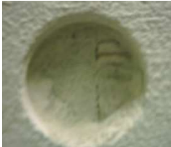
Figura 24: superfície de ruptura após arrancamento
