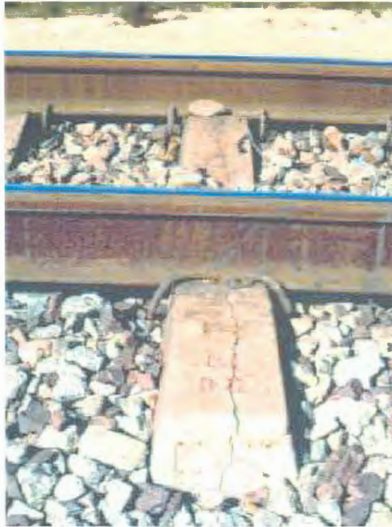
Figura 6: dormentes de concreto atingidos por RAA, em ferrovia na África do Sul (FOURNIER, 2005).
