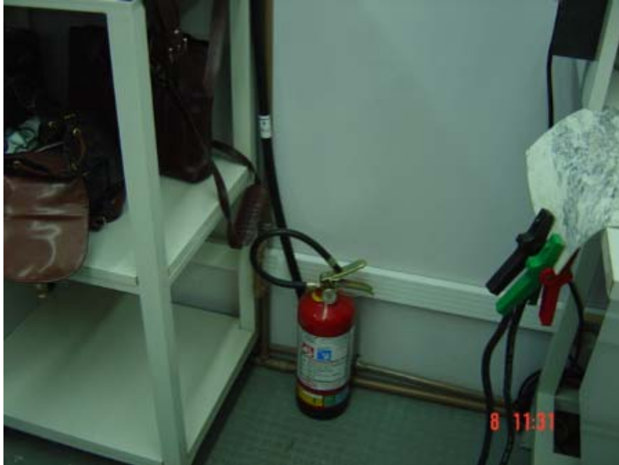
Figura 14 – Posicionamento do extintor no laboratório
