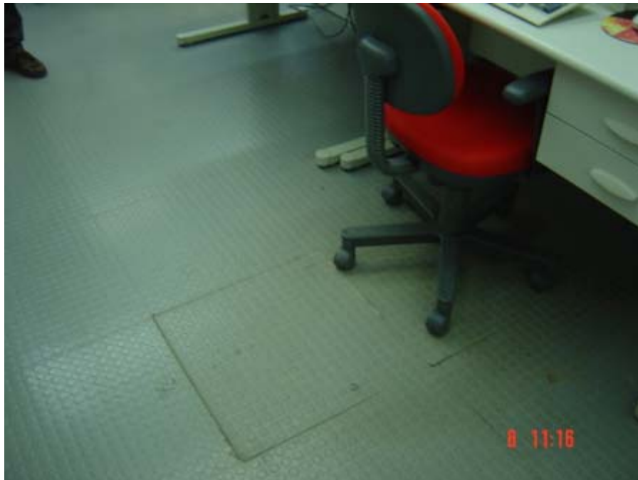
Figura 11 – Descolamento do piso
