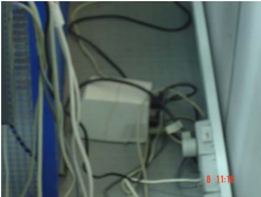
Figura 13 – Irregularidade nas instalações elétricas
