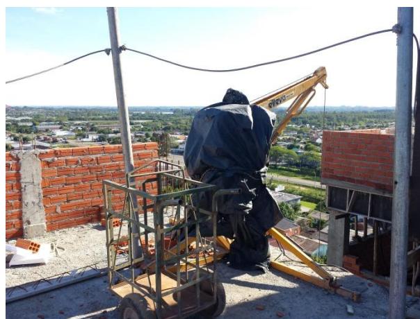
Figura 33 – Minigrua instalada sem guarda-corpo na obra 09
