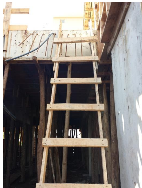
Figura 22 – Escada de mão com comprimento inadequado na obra 07
