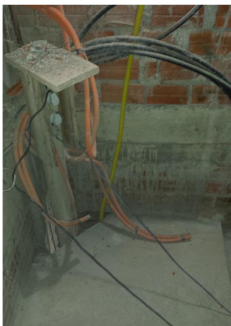
Figura 34 – Ramal elétrico com problemas de segurança na obra 04
