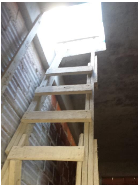
Figura 21 – Escada de mão com emenda na obra 09
