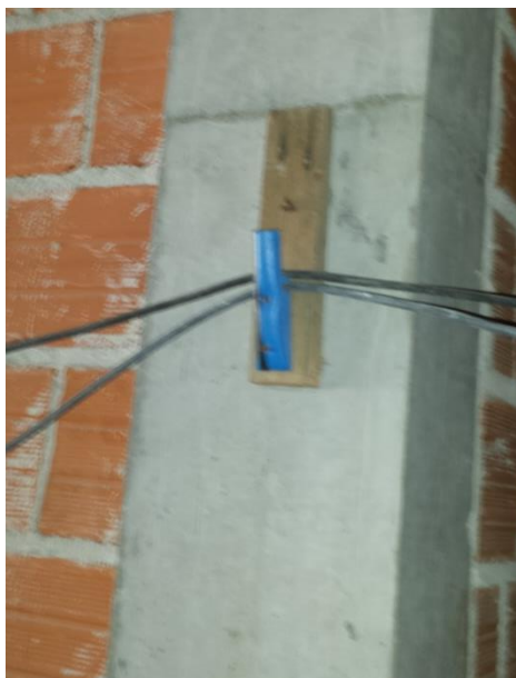
Figura 36 – Sistema simples para manter os fios suspensos na obra 05
