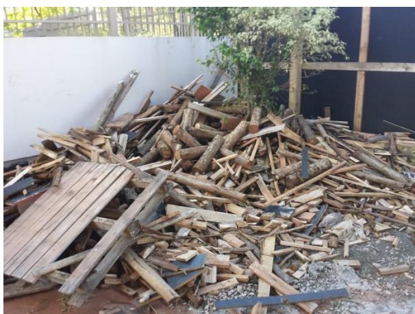
Figura 8 – Falta de organização do entulho na obra 09
