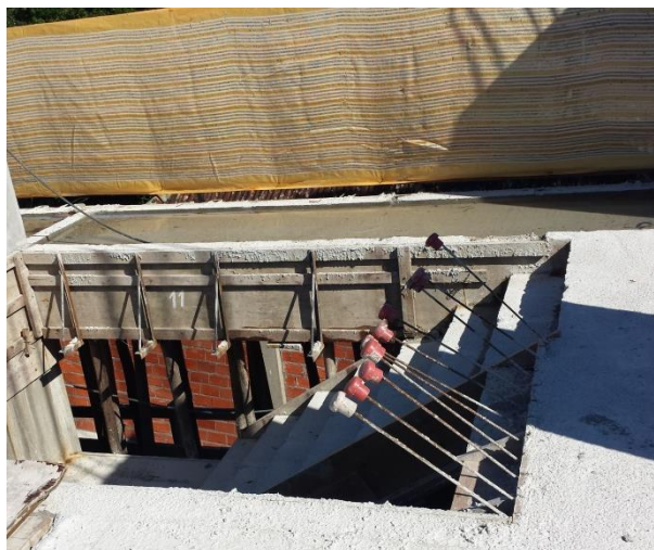
Figura 38 – Pontas de vergalhões protegidas na obra 08
