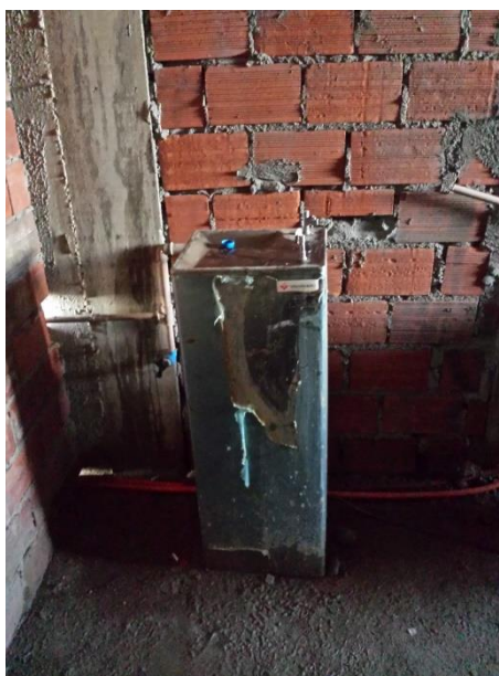
Figura 18 – Bebedouro localizado no penúltimo pavimento na obra 11
