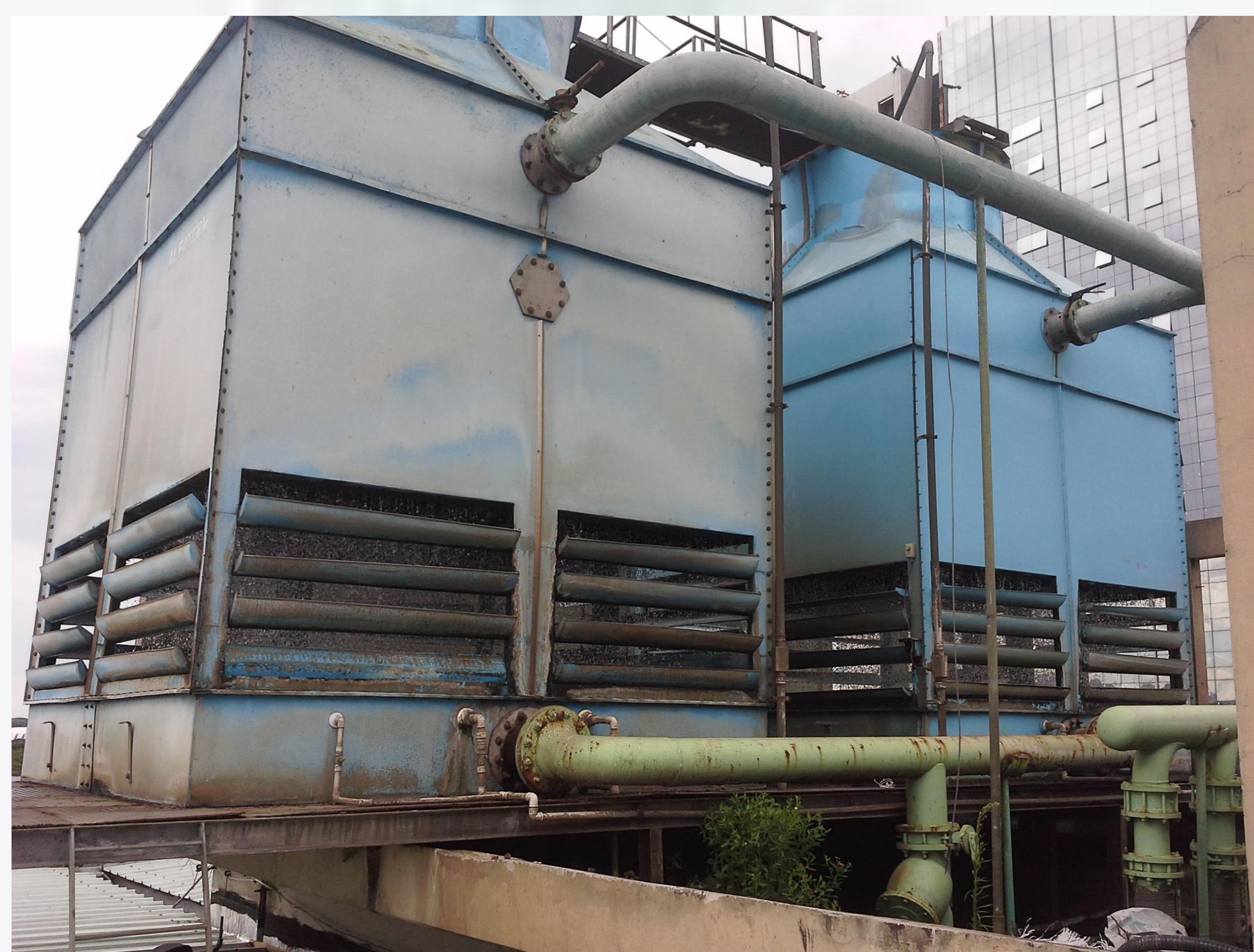
Torre de resfriamento de ar condicionado onde foram coletadas algumas amostras para o estudo.
