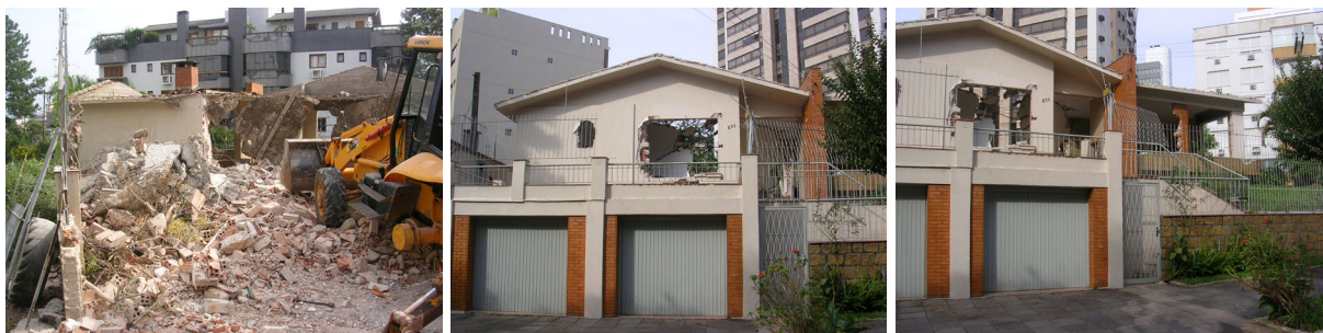
Figura 69: Estrutura com concreto, cerâmica e argamassa: materiais amorfos (Demolição B)
