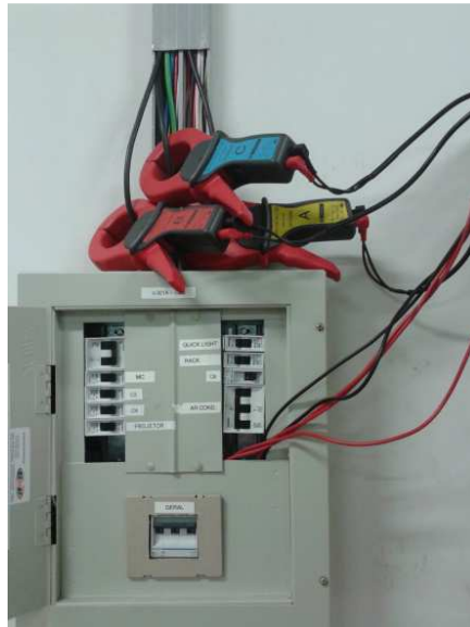
Figura 16 – Ligação do Analisador de Energia na CDI do ambiente analisado. Fonte: Fotografado pelo autor.
