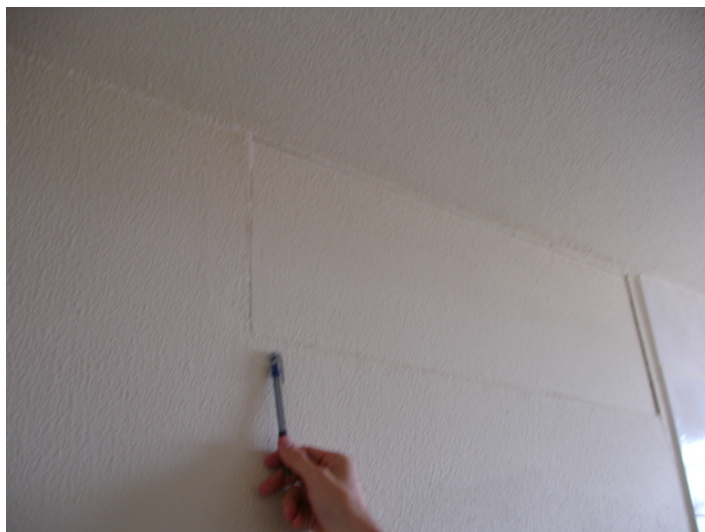
Figura 38: fechamento da inspeção das instalações sanitárias mal posicionada
