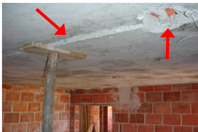
Figura 59: desnível acentuado no encontro dos painéis de lajes da sala e desencontro das tubulações das instalações elétricas
