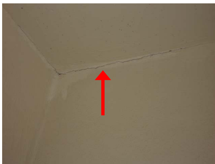
Figura 41: fissura na interface do apoio da laje sobre a parede
