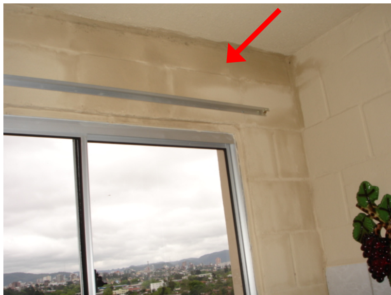
Figura 37: problemas de infiltração nas faces internas das paredes do dormitório
