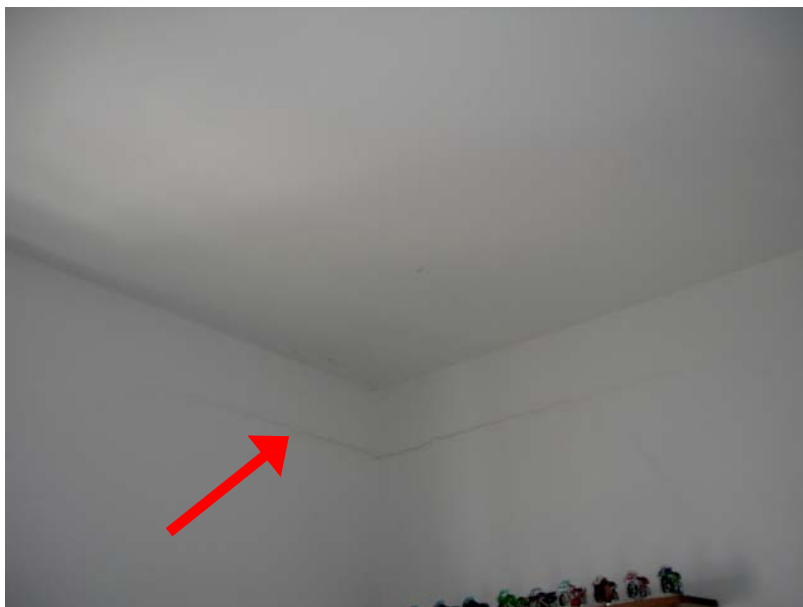
Figura 36: fissura horizontal na face interna da parede próxima à laje de cobertura
