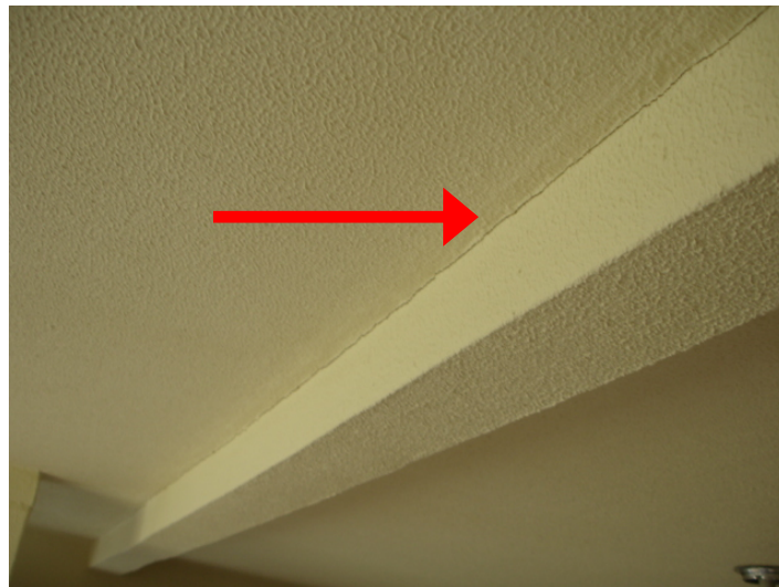
Figura 43: fissuras localizadas na união dos painéis de laje da sala e cozinha
