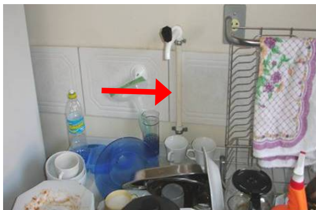
Figura 46: tubulação aparente de água da torneira da pia da cozinha nos sobrados
