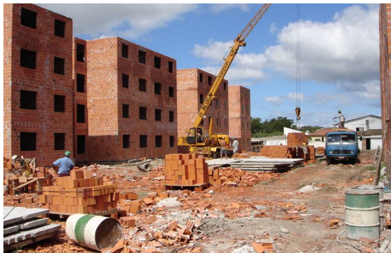
Figura 61: desperdício de blocos em excesso
