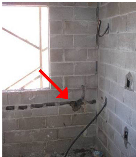
Figura 52: cortes horizontais excessivos na alvenaria
