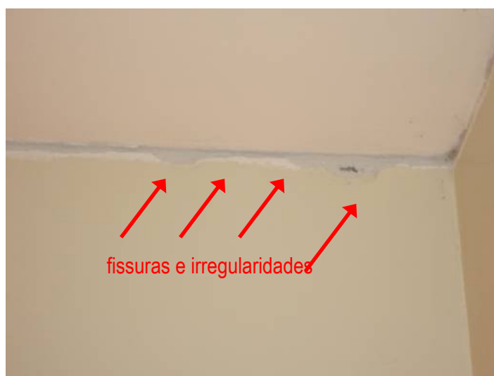
Figura 39: fissuras e irregularidades na interface da laje de teto com as paredes
