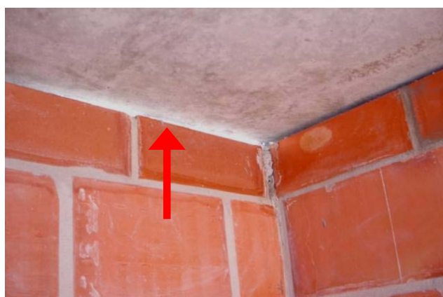
Figura 58: desnível da cinta de respaldo
