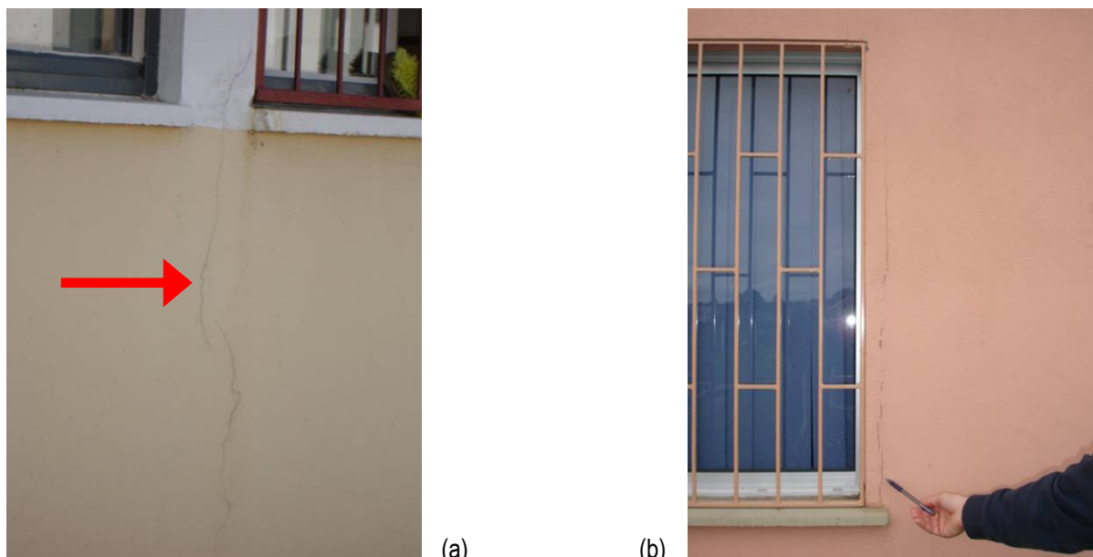
Figura 34: (a) fissura vertical na face externa da parede que divide duas áreas de serviço; (b) fissura vertical do revestimento de argamassa da lateral do vão da janela
