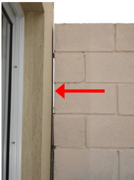
Figura 35: falta de vedação entre o muro do pátio e a parede externa dos sobrados
