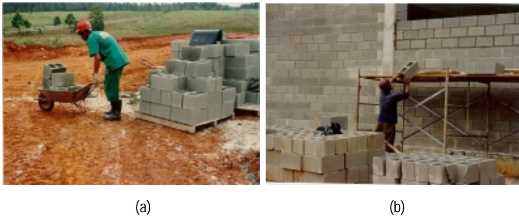
Figura 5.8 – Transporte de blocos: (a) transporte para o posto de trabalho; (b) colocação dos blocos em andaime
