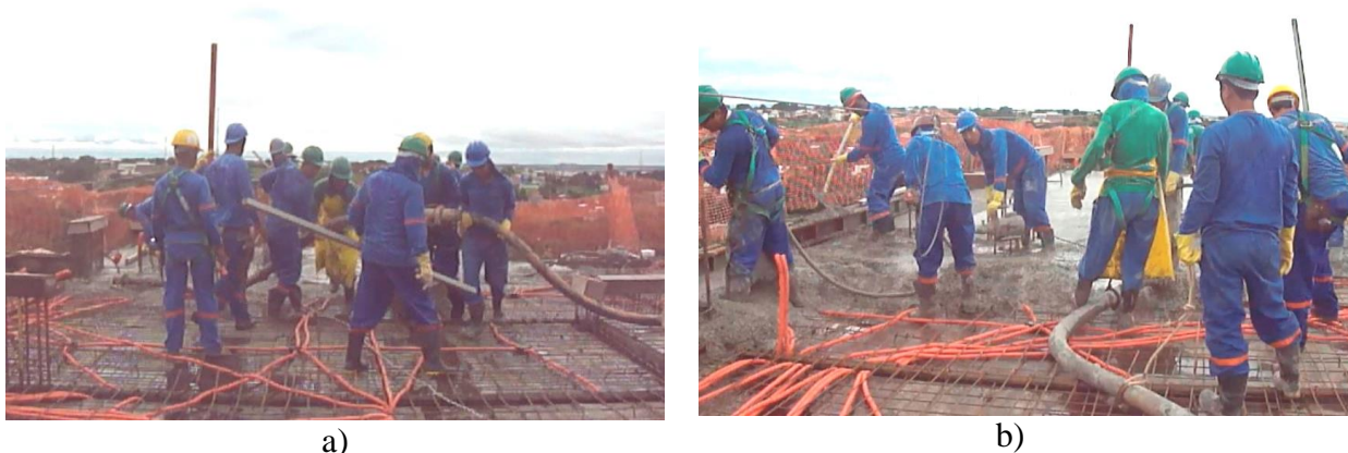
Figura 20 - Concretagem de pilares, vigas e lajes por bombeamento do concreto: a) carregamento do mangote sobre a laje; b) espalhamento e vibração do concreto.
