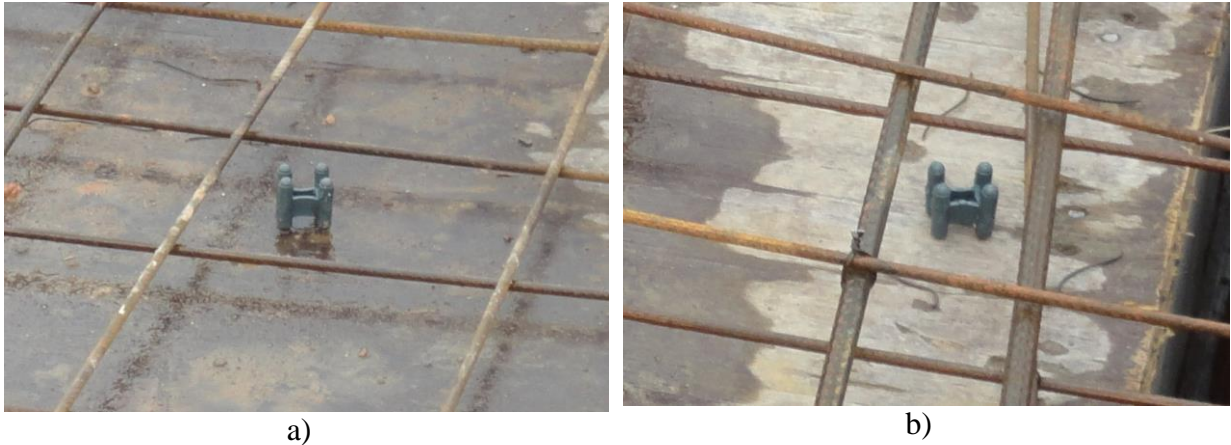
Figura 25 - Espaçadores que se soltaram da armadura, não desempenhando mais a sua função.
