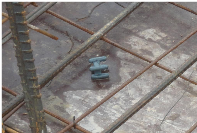
Figura 26 – Espaçador tombado durante um concretagem.
