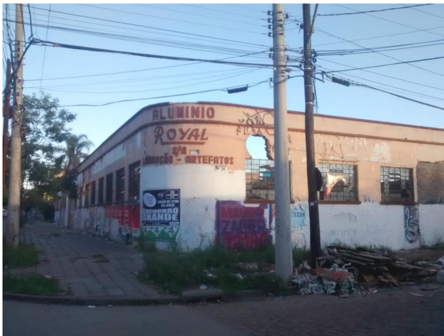
Figura 7 - Acúmulo de lixo e abandono na fachada da antiga fábrica Alumínio Royal, no cruzamento das avenidas Brasil e Amazonas, no bairro Navegantes.
