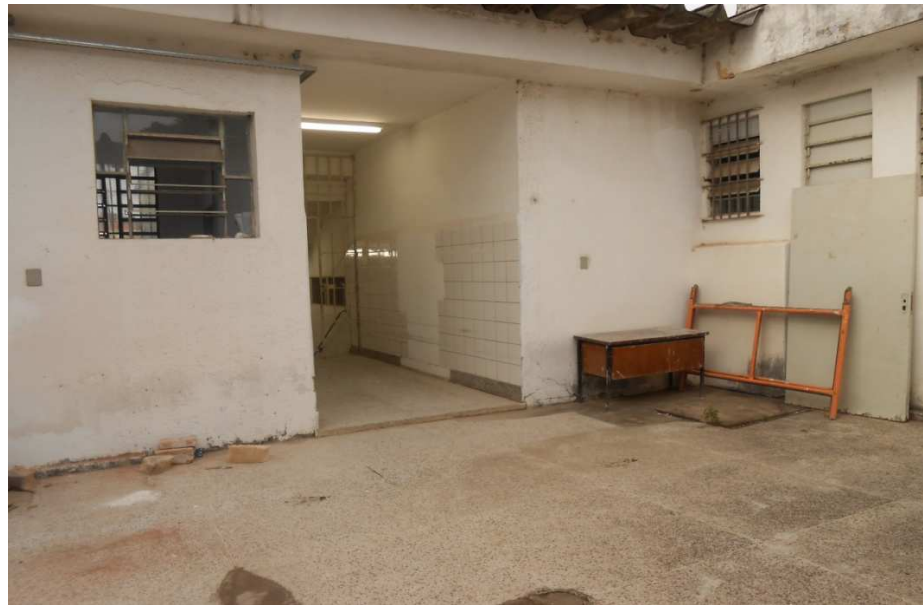
Figura 5 - Entrada da área de isolamento de pacientes no Setor de Admissão e Triagem
