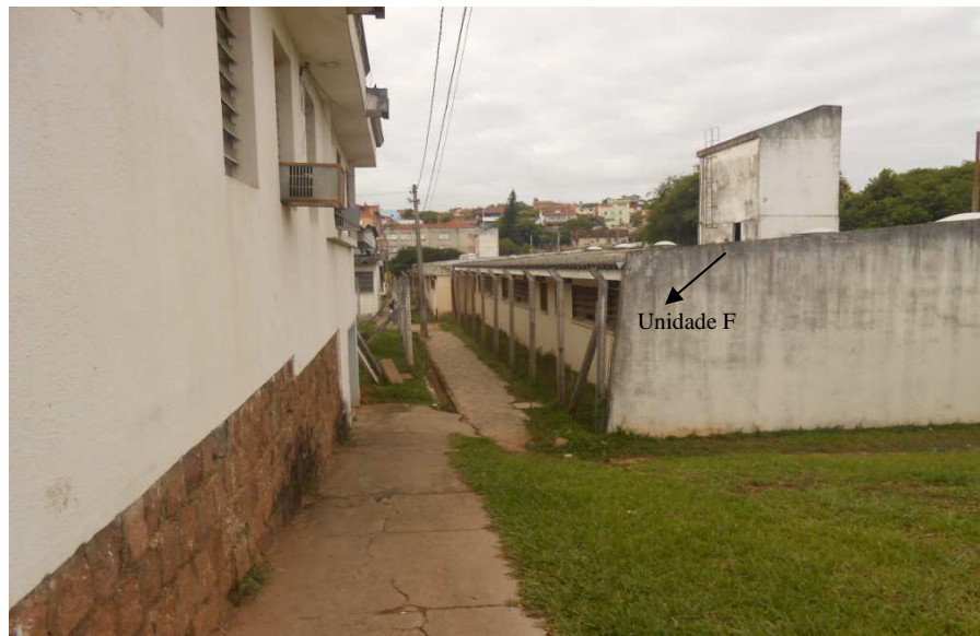
Figura 6 - Área externa da Unidade de Tratamento F
