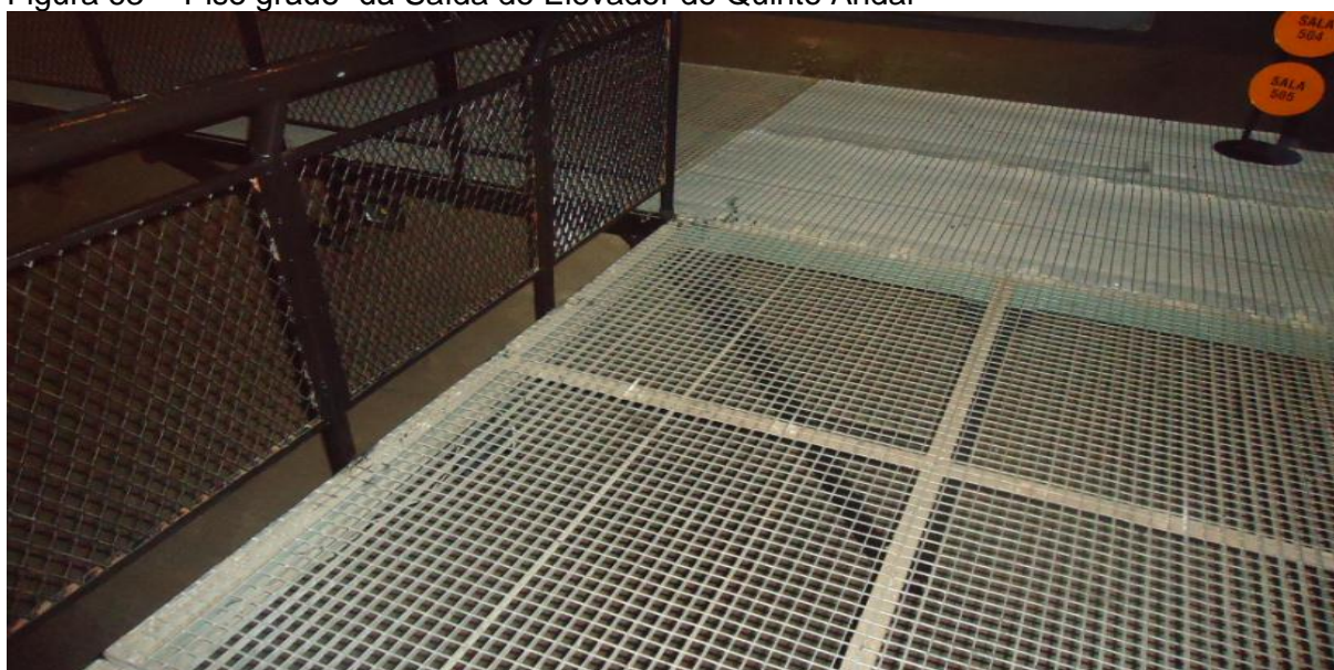
Figura 63 - “Piso grade” da Saída do Elevador do Quinto Andar
