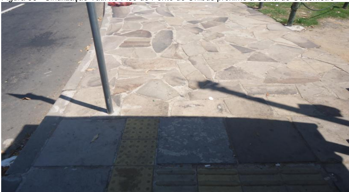
Figura 36 - Sinalização Tátil no Piso do Ponto de Ônibus próximo à Usina do Gasômetro
