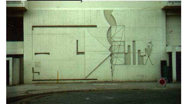
Baixo-relevo em concreto aparente, Le Corbusier. Fonte: www.vitruvius.com 12.Mar.06
