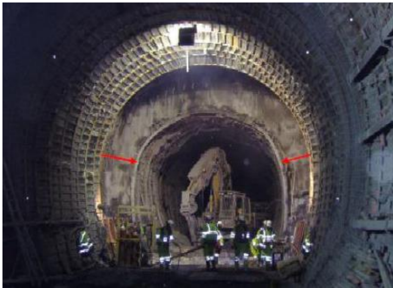
Figura 19 Ocorrência de squeezing na construção do túnel para a ligação de alta velocidade entre Lyon e Turim (MELÂNEO, 2011).
