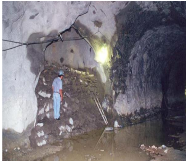
Figura 17 Colapso da parede lateral de um túnel na Central Elétrica de Queimado, Brasil, 2002 (SEIDENFUSS, 2006).
