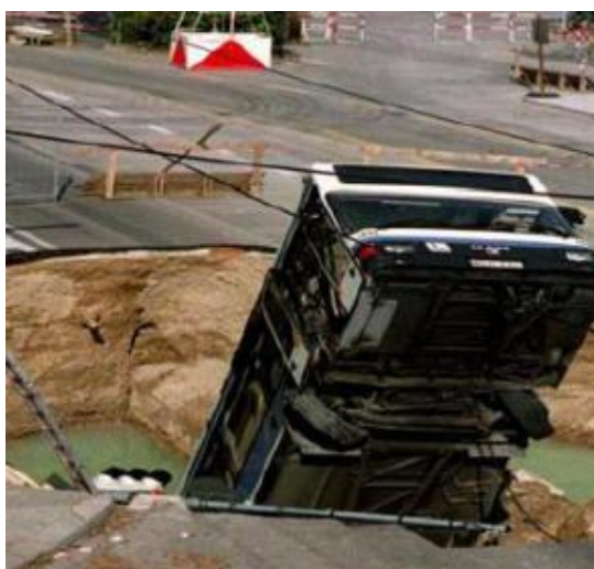
Figura 16 Rua colapsada em Munich, ano 1994 [ http://munichre.com ].
