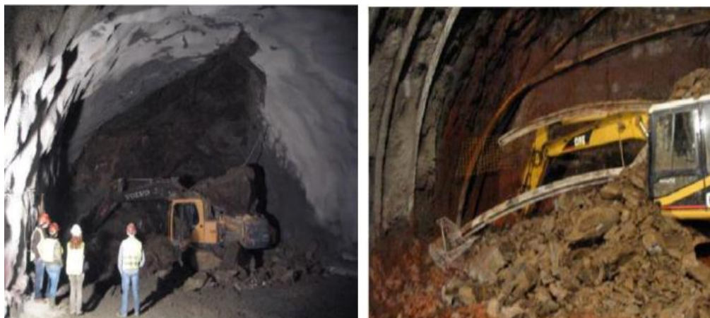
Figura 21 Desabamento da frente de escavação (à esquerda) e do topo do túnel (à direita). (BRADY; BROWN, 2006)
