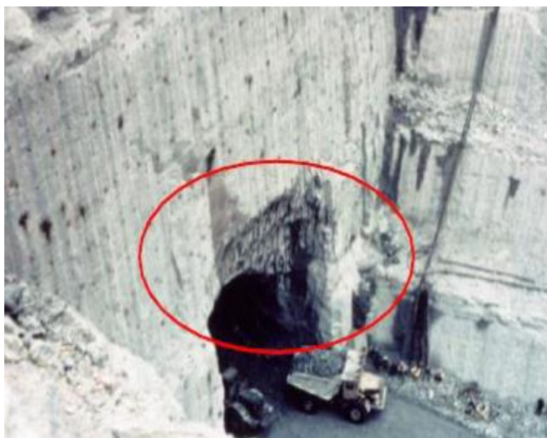
Figura 20 Queda da frente da entrada do túnel (SEIDENFUSS, 2006).
