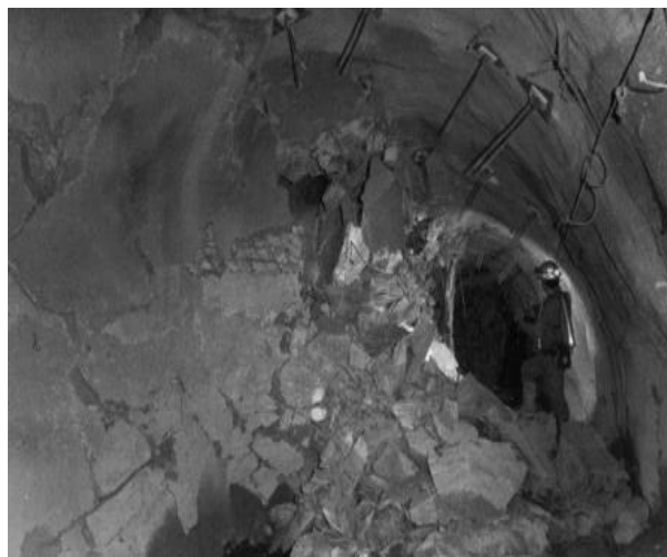
Figura 18 Danos no túnel pela ocorrência de rock burst numa mina na África do Sul [ http://sciencedirect.com ]
