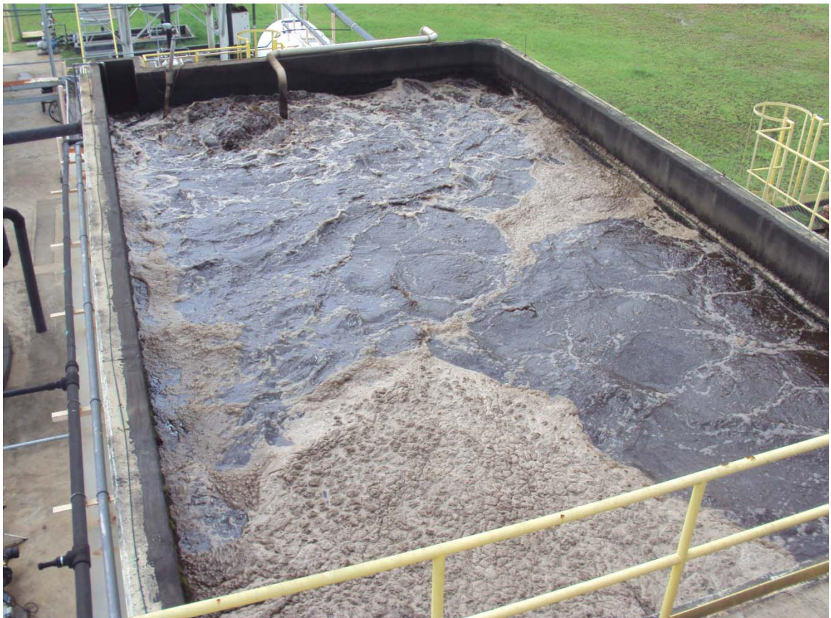
Anexo I: Tanque de aeração – Indústria do Tabaco.
