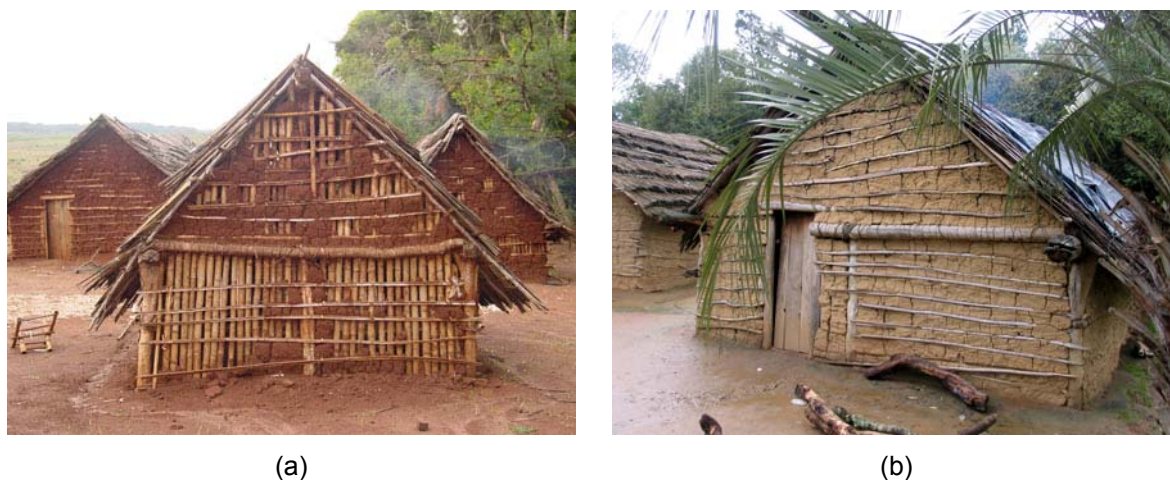
Figura 20: (a) revestimento deteriorado - Tekoa Koenju ; (b) revestimento conservado – Tekoa Anhetenguá . Fonte 21b: Vivian Ecker
