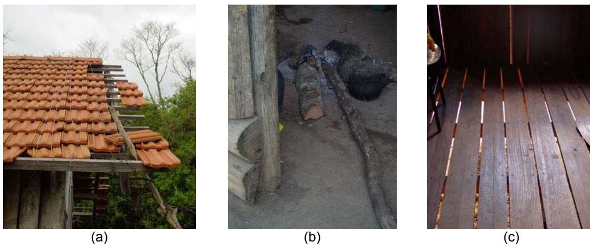
Figura 27: Problemas identificados pelos juruá : (a) telhas caindo; (b) pilares apodrecendo na base; (c) frestas no assoalho.
