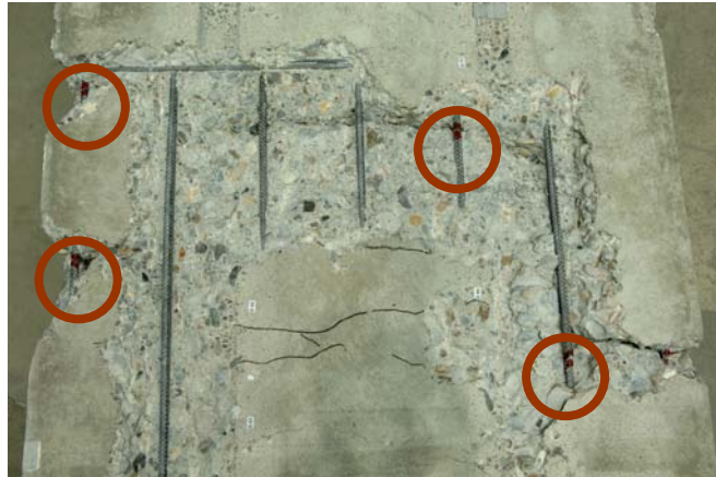
Figura 2.10 – Resultado de inspeção em viga de concreto armado após ruptura em teste de fadiga.
