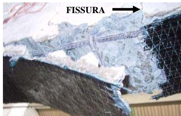
Figura 2.9 – Ruptura do PRF devido a movimentações diferenciais nas bordas de fissuras de flexão.
