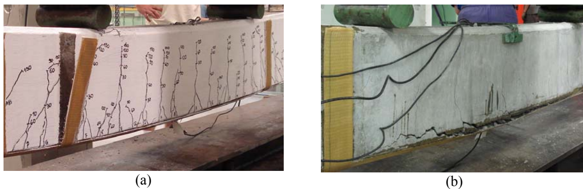
Figura 5.5 – Viga VFA_02: (a) Detalhe do laço de ancoragem descolado; (b) Descolamento do compósito na face tracionada da viga.
