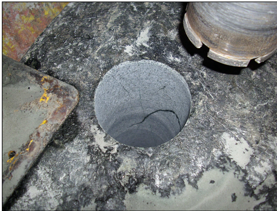
Figura 26 – Fisuras internas del pétreo.
