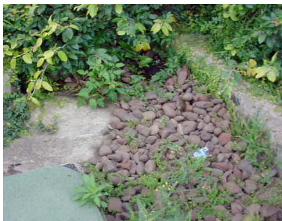
Figura 119: ralo, escondido sob a vegetação
