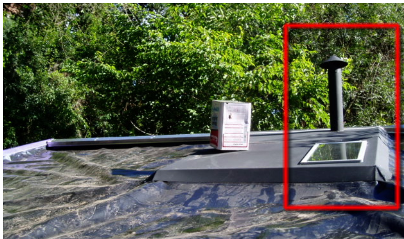
Figura 72: ventilador eólico e iluminação zenital (MENZ, 2004)
