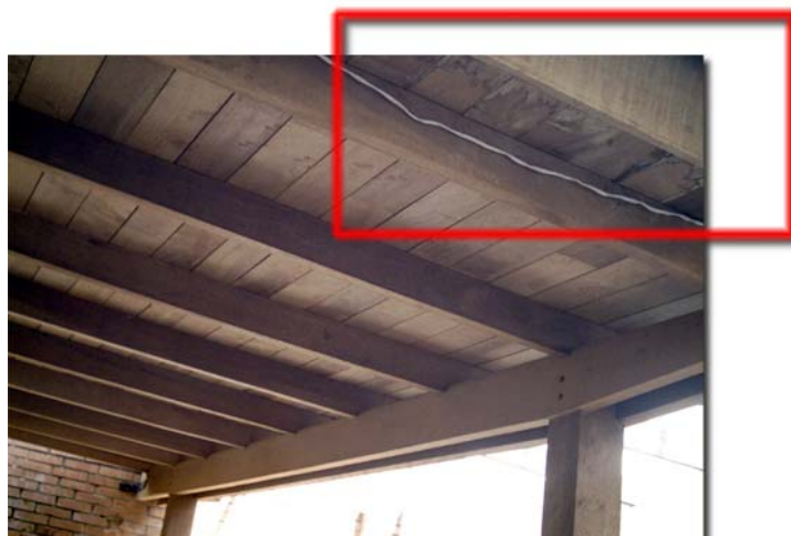
Figura 46: infiltração na cobertura
