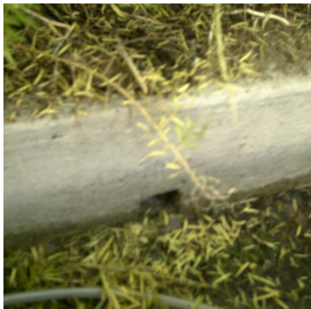
Figura 35: calha posterior à cobertura viva
