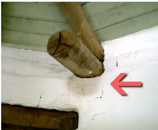
Figura 42: infiltração no interior da casa
