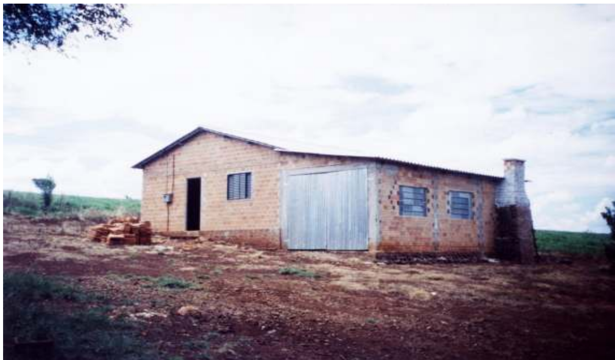
Figura 75. Casa de alvenaria de tijolos furados aparentes, em regular estado de conservação
