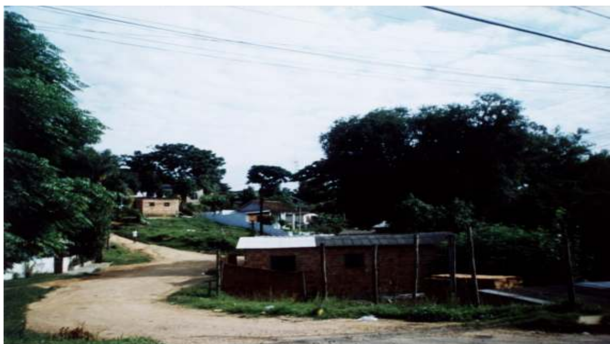
Figura 87. Casa de alvenaria de tijolos furados, sem revestimento, em precárias condições de conservação
